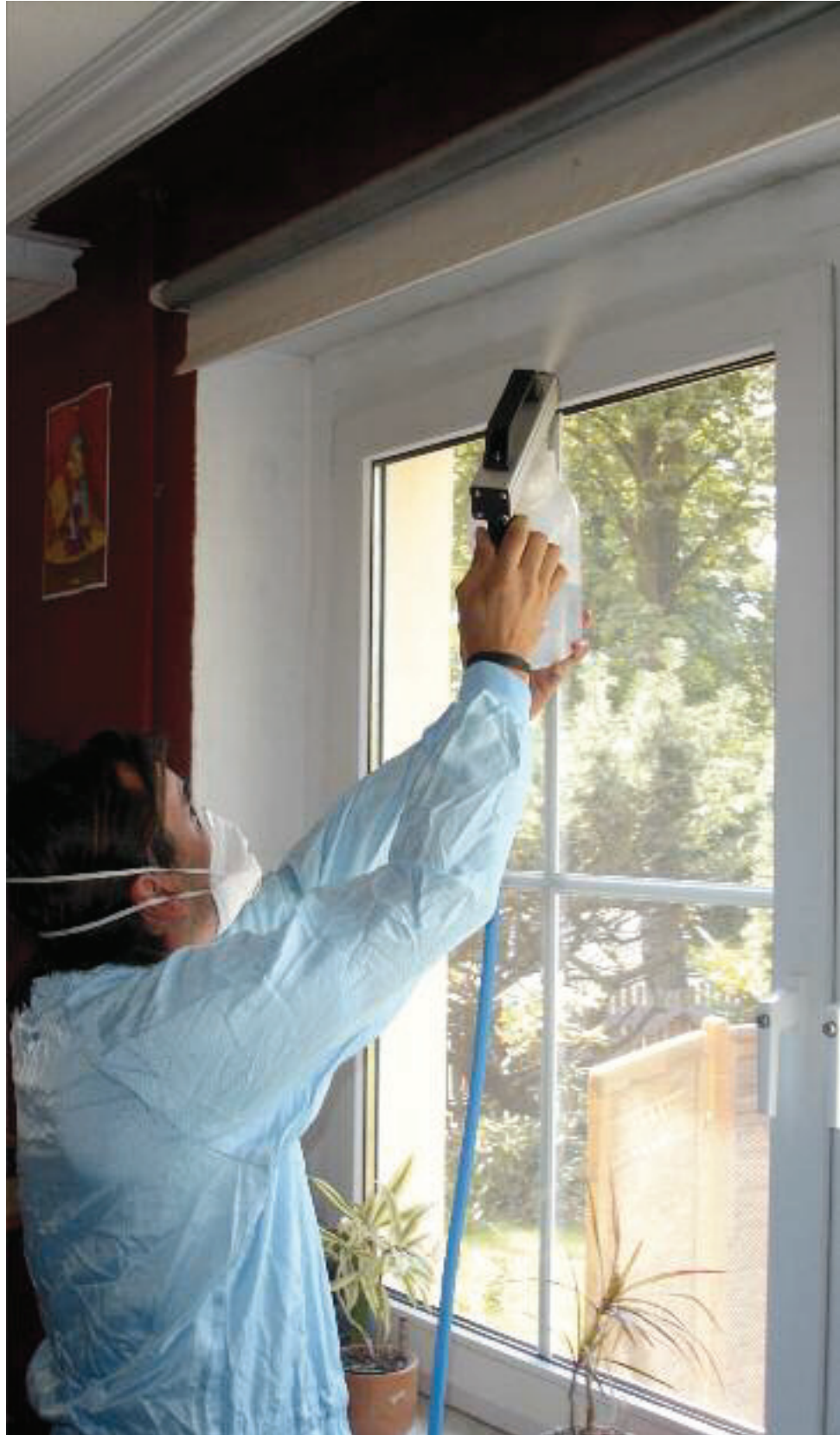
Schimmelbefallene Wohnungen können jetzt auch ohne Chemie saniert werden.
