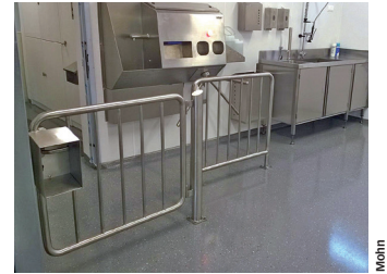
Die Hygienelösung „Cleanlight TOP I“ sorgt für optimale Handhygiene. Das elektrische Drehkreuz gibt den Weg erst nach erfolgter Reinigung und Desinfektion frei.
