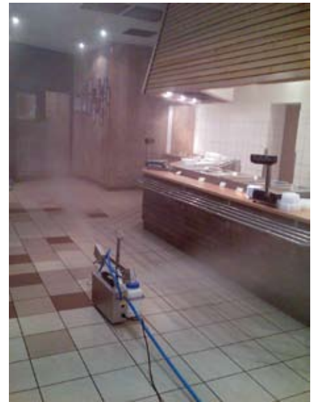
Kaltvernebelung im Gastrobereich mit ValloFog
