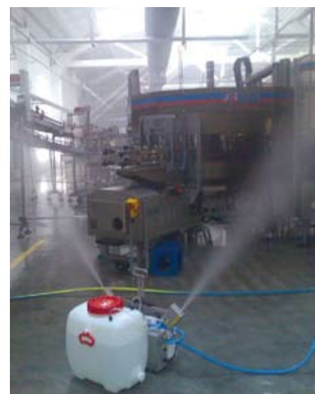
ValloFog-Vernebelung in einer Brauerei
