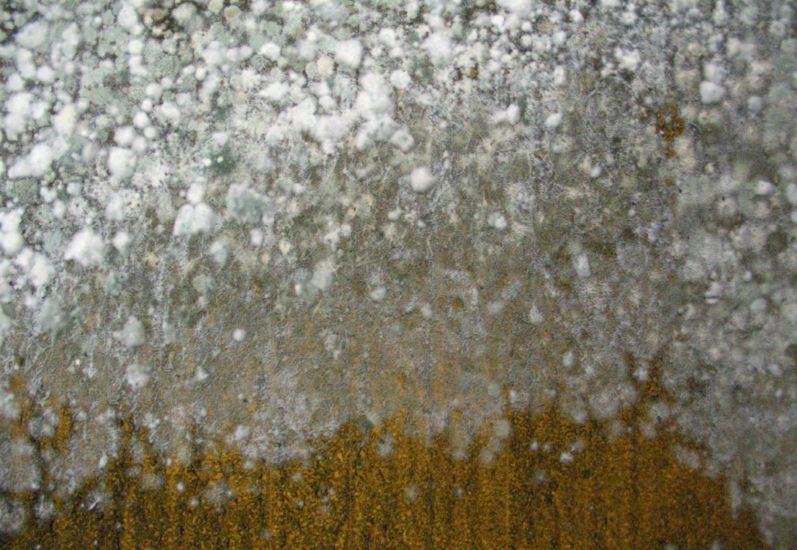
Schimmelpilzbefall eines Schalldämpfers.
