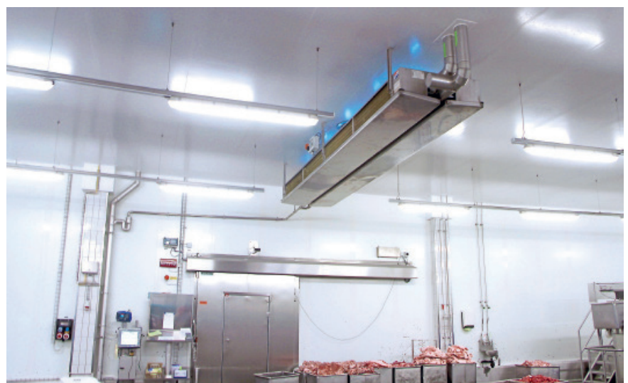
Die UVC-Module von sterilAir wurden direkt im Verdampfer integriert und sorgen rund um die Uhr für keimfreie Luft.
